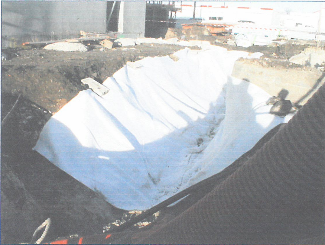
figure 6 : Cliché ( du 01/02/02) d'une tranchée préparée (pose du géotextile) à recevoir une canalisation AEP sous chaussette géomembrane sur le site des ateliers du tramway sis quai des Queyries à Bordeaux (33).
